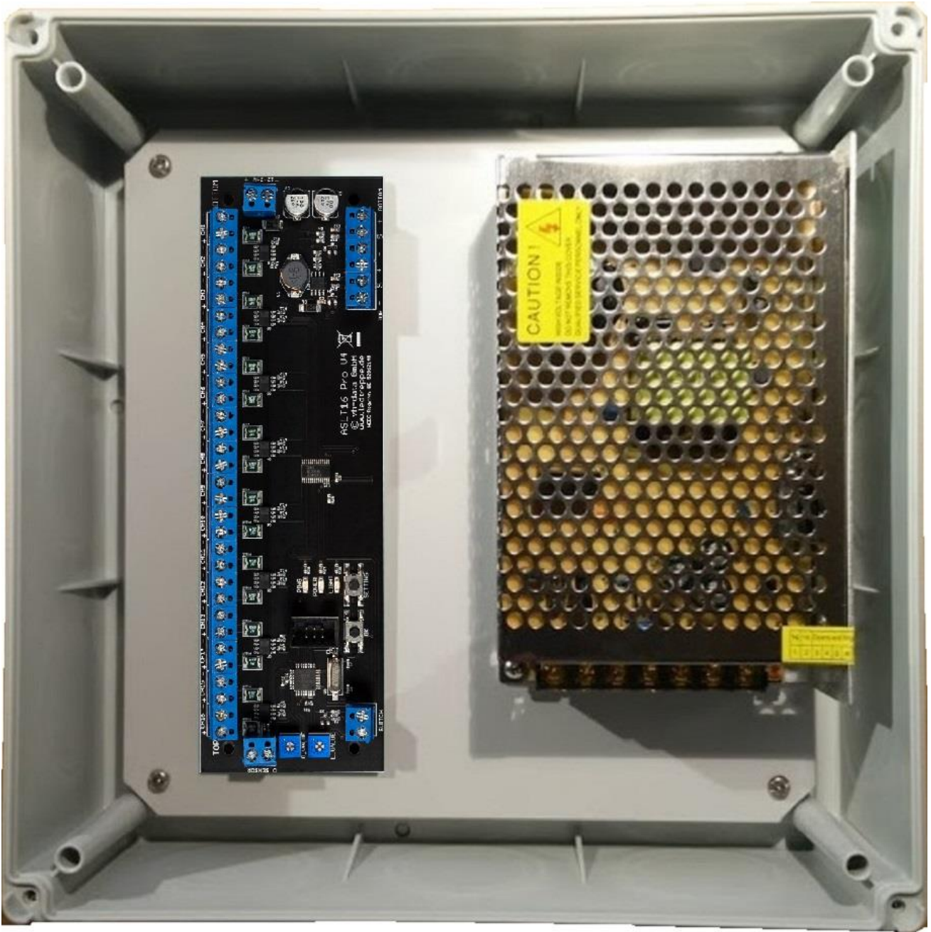
Abbildung 8: Standard ASLT16 Pro V4 inkl. 100W Netzteil im Metallgehäuse fertig montiert im Kleinverteiler Gehäuse
